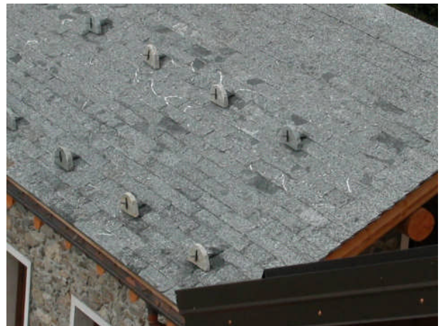
copertura non accettabile
